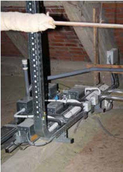
Om de residentiële binnentoestellen te kunnen aansluiten op het VRF-circuit, werden de expansieventielen apart geplaatst, bijvoorbeeld in een zolderruimte.
