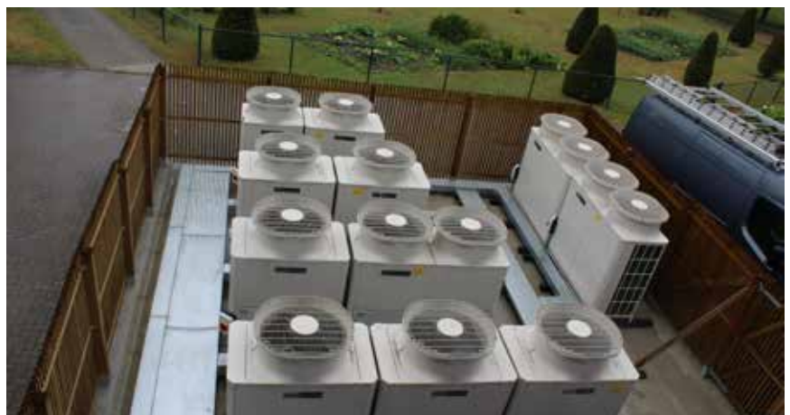
De buitenunits werden in drie groepen geplaatst, en aan het zicht onttrokken door een omheining.
